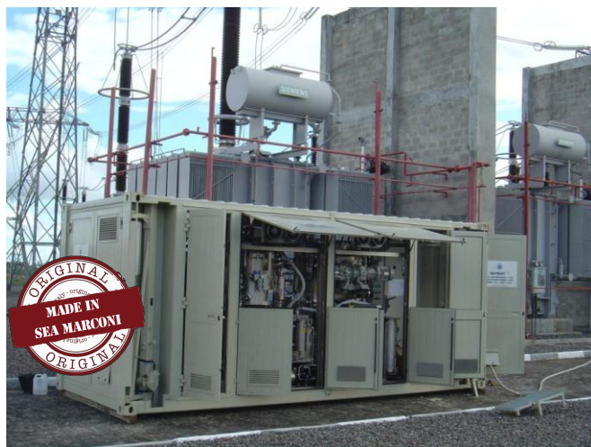
Esempio di DMU Sea Marconi per trattamenti di trasformatori a 500 KV Brasile (2009)
